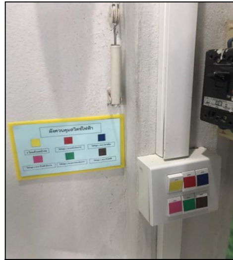
สีสัญลักษณ์บนแผงควบคุมสวิตช์ไฟฟ้า
